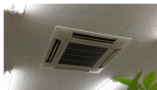
冷房の効きが悪い
