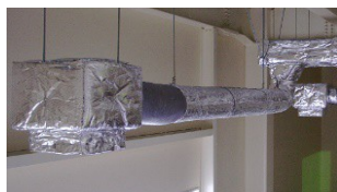
送風量が足りていない
