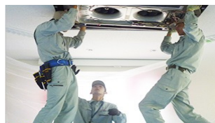
空調機を入れ替えたい
