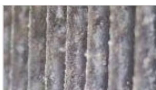
油で熱交換器が壊れる
